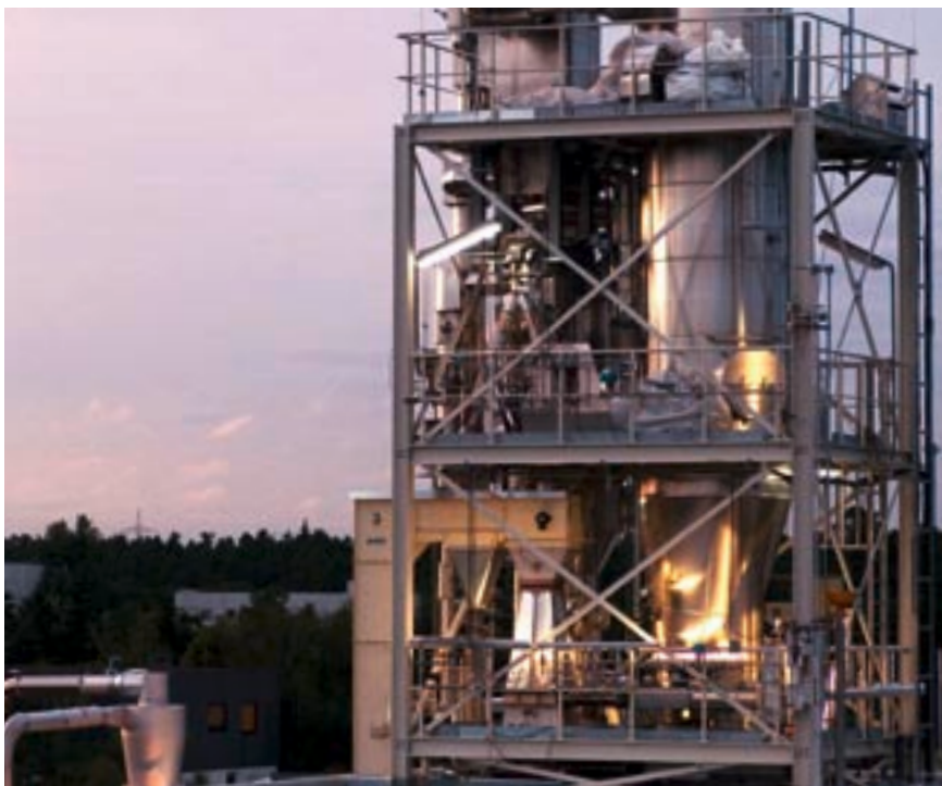
Die bioliq-Anlage soll Stroh und Holz in Sprit verwandeln. Zum Teil bereits fertig, soll sie bald komplett in Betrieb gehen.
